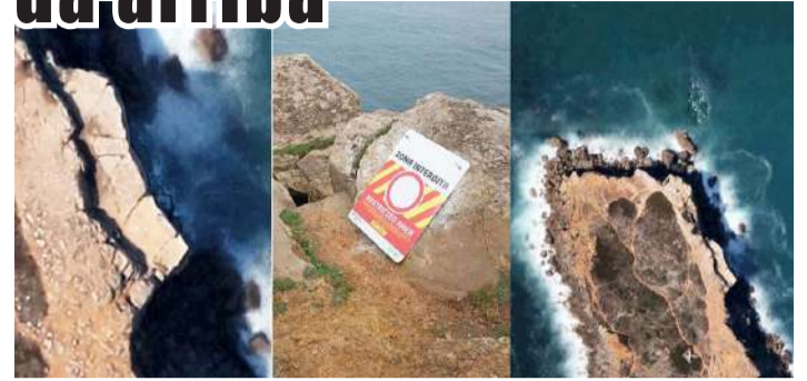
Deterioração na arriba da península da Papôa, em Peniche, levou à interdição da zona
